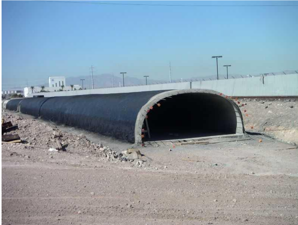
Slika Jajasti i spljošteni profil kolektora
